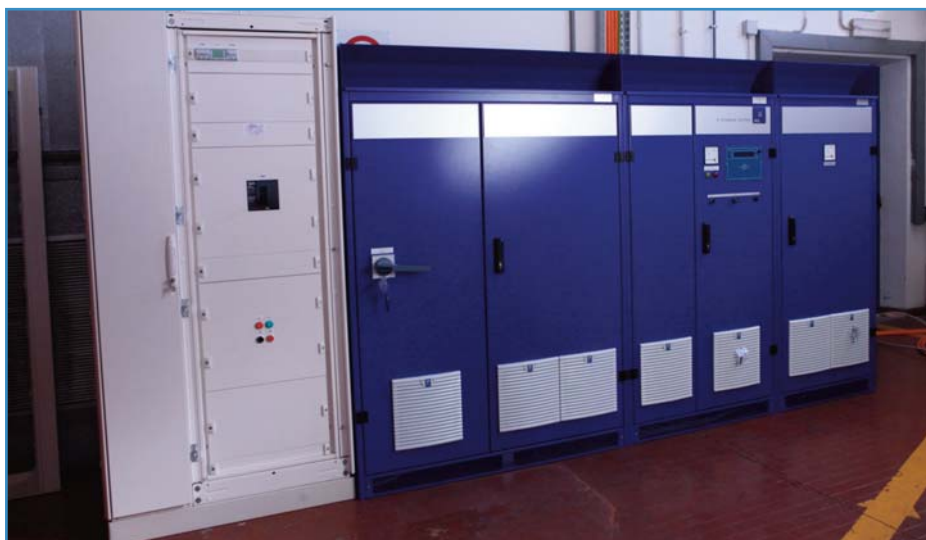
Laboratorio Prova Batterie – Ciclatore 250kW; 0-800V; 600A
