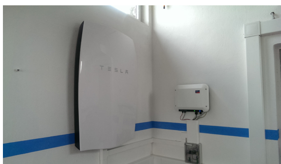
Sistema di accumulo monofase SMA - TESLA (6,4 kWh)
