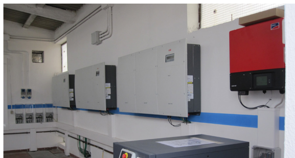
Sistema di accumulo trifase ABB (12 kWh)
