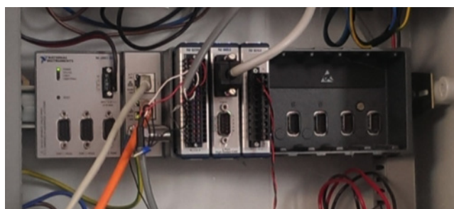
Energy Management System (EMS) dell'impianto fotovoltaico con accumulo
