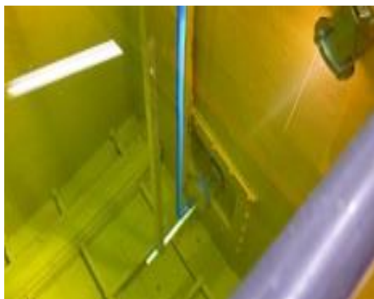
Fig. 6 - Cavità posizionata nella piscina in corrispondenza della Colonna termalizzante.
