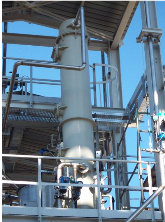
Figura 2.4. Colonna a riempimento di desolforazione a freddo del syngas.
