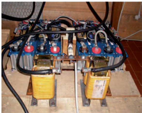
Accumulo misto batterie + supercondensatori sviluppato in ENEA
