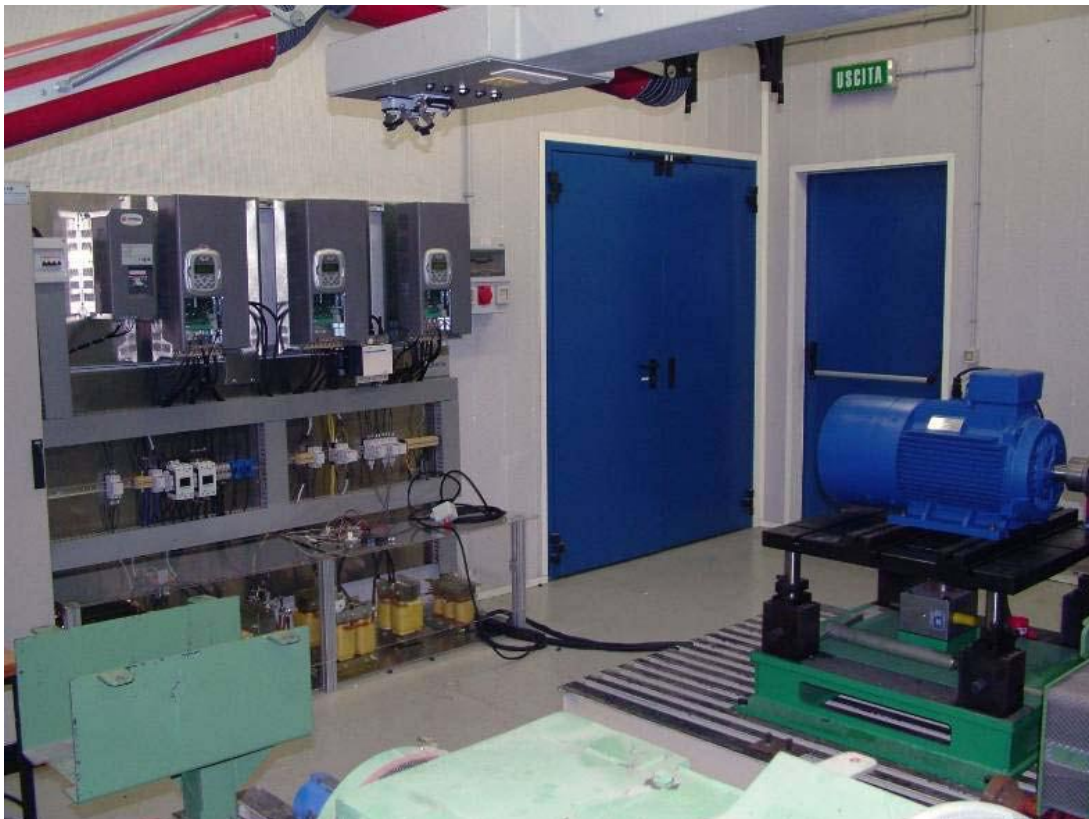
Fig. 13 Stazione prova ENEC
