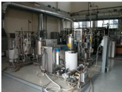
Impianto di filtrazione a membrana
