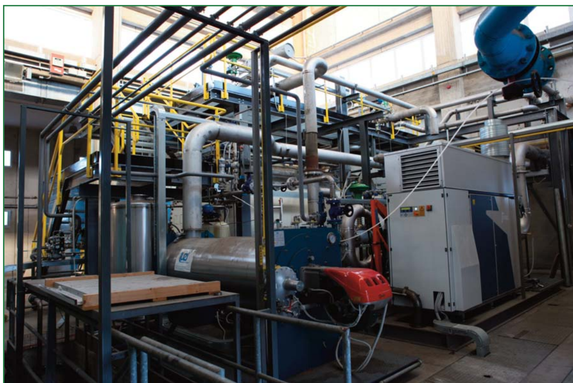
A sinistra, in primo piano, il generatore di vapore da 700 kWt. A destra la \mu\text{TG} Turbec T100 da 100 kW e
