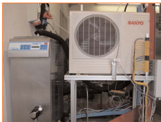
Impianto sperimentale Pa.CO 2
