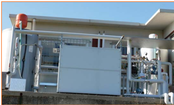
Impianto AI.CO.WA.: pompa di calore a R744 (CO 2 )
