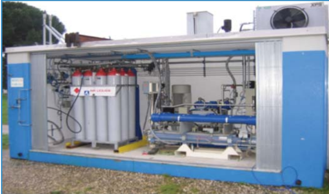
Minirete per il rifornimento di idrogeno, metano e miscele ad alta pressione
