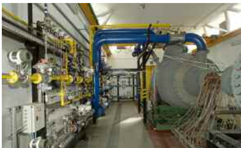
Impianto sperimentale CERTEM per la qualificazione di materiali e componenti in condizioni severe di lavoro
