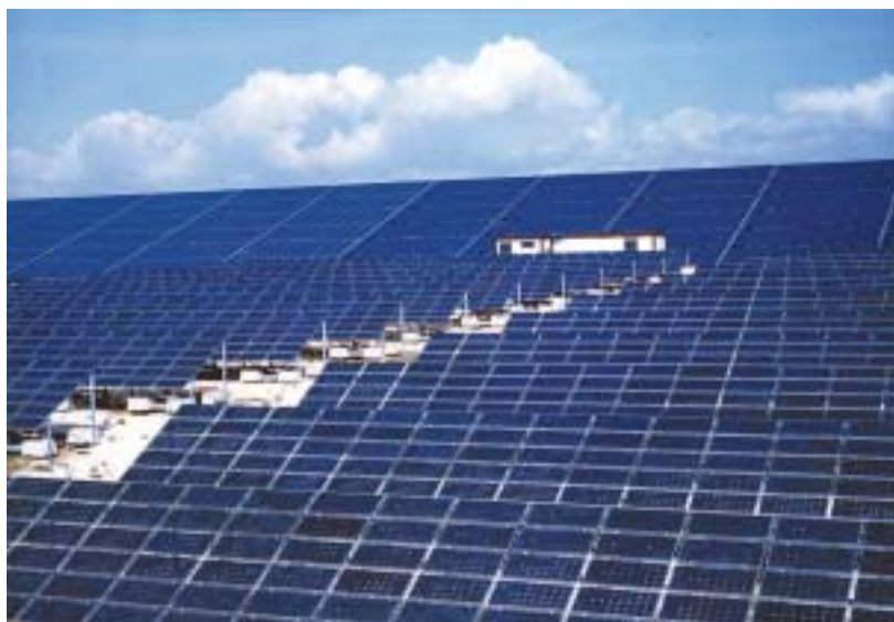
Impianto fotovoltaico Delphos: in primo piano la seconda sezione dell'impianto
