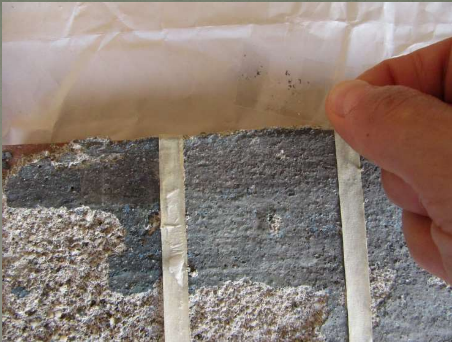
Prova a strappo con nastro adesivo Zona trattata con Nopalgel
