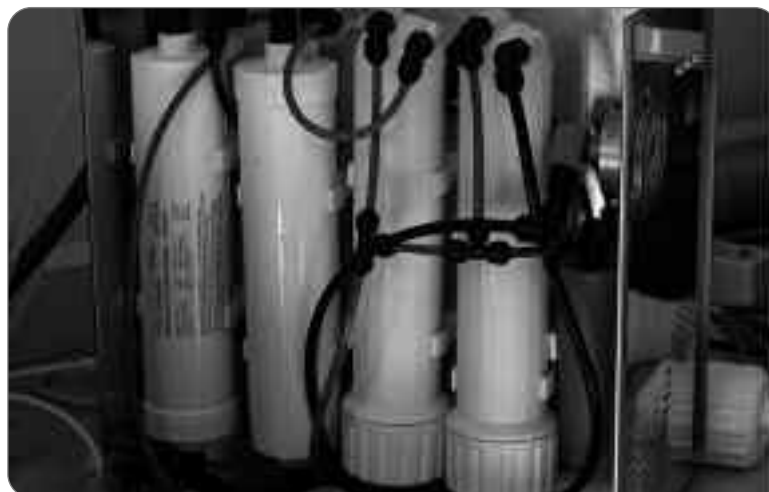
Figura 3 Dispositivo per il trattamento delle acque domestiche, con membrane osmotiche e filtri a carbone attivo
